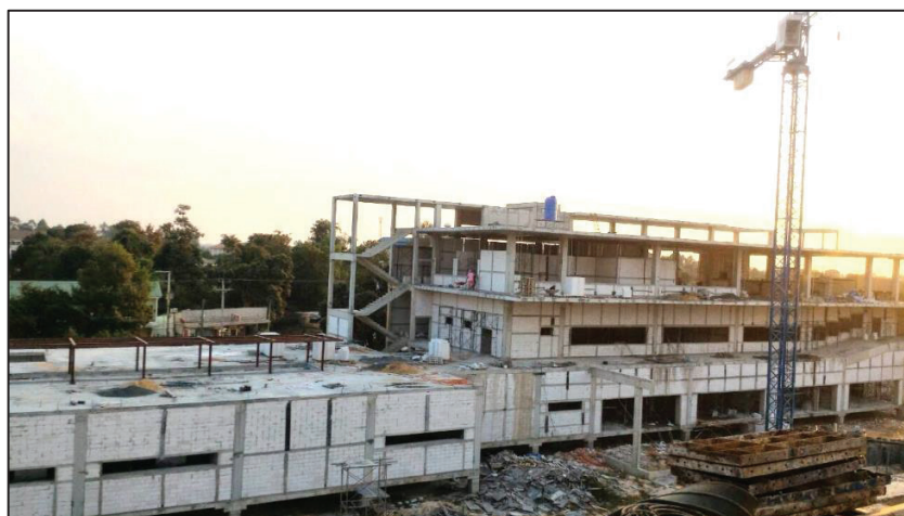
ภาพที่ 36 การก่อสร้างอาคารกายวิภาคศาสตร์ เพื่อรองรับจำนวนนักศึกษาที่เพิ่มขึ้น
